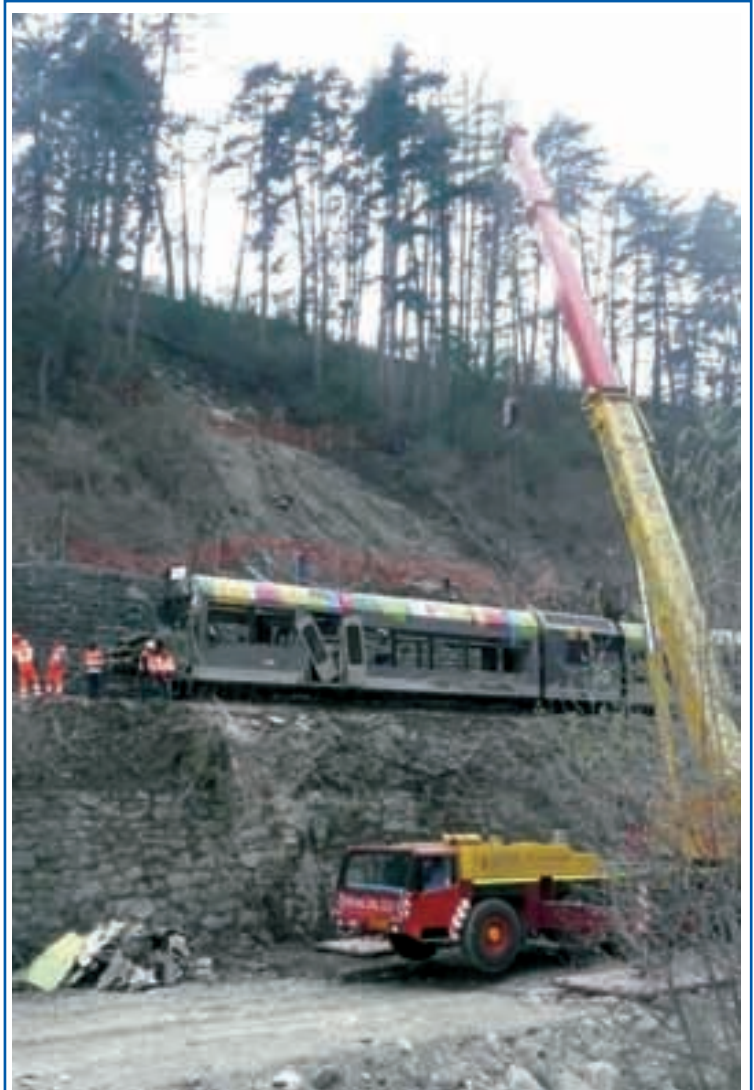
Figura 7.17: Frana sulla linea ferroviaria Malles–Merano (BZ) 19
