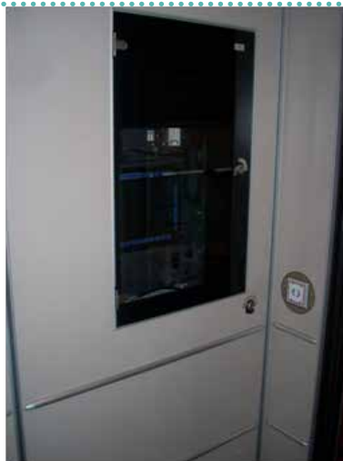
Figura 2: Particolare del cavo fessurato nella carrozza (ESAV 9699 e ESAV 95)
